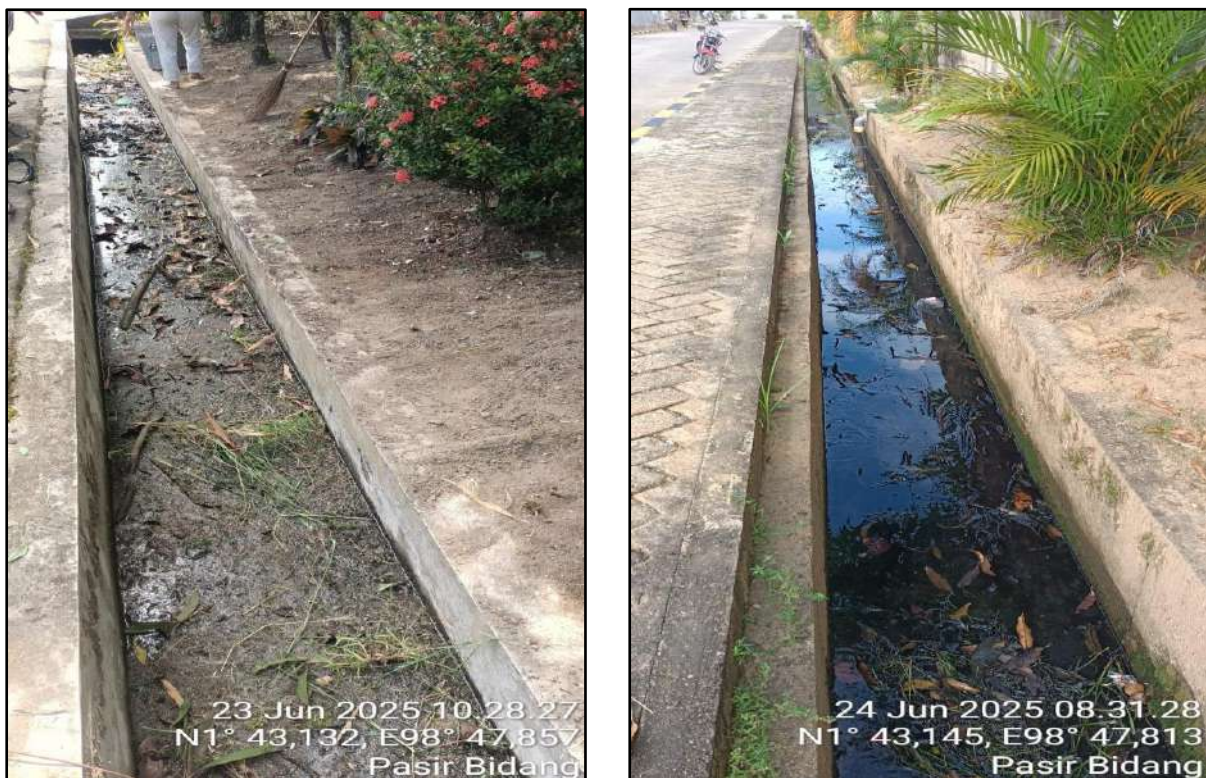
Gambar 1. Hasil identifikasi dan Jenis kerusakan drainase depan PPN Sibolga (zona 4)
