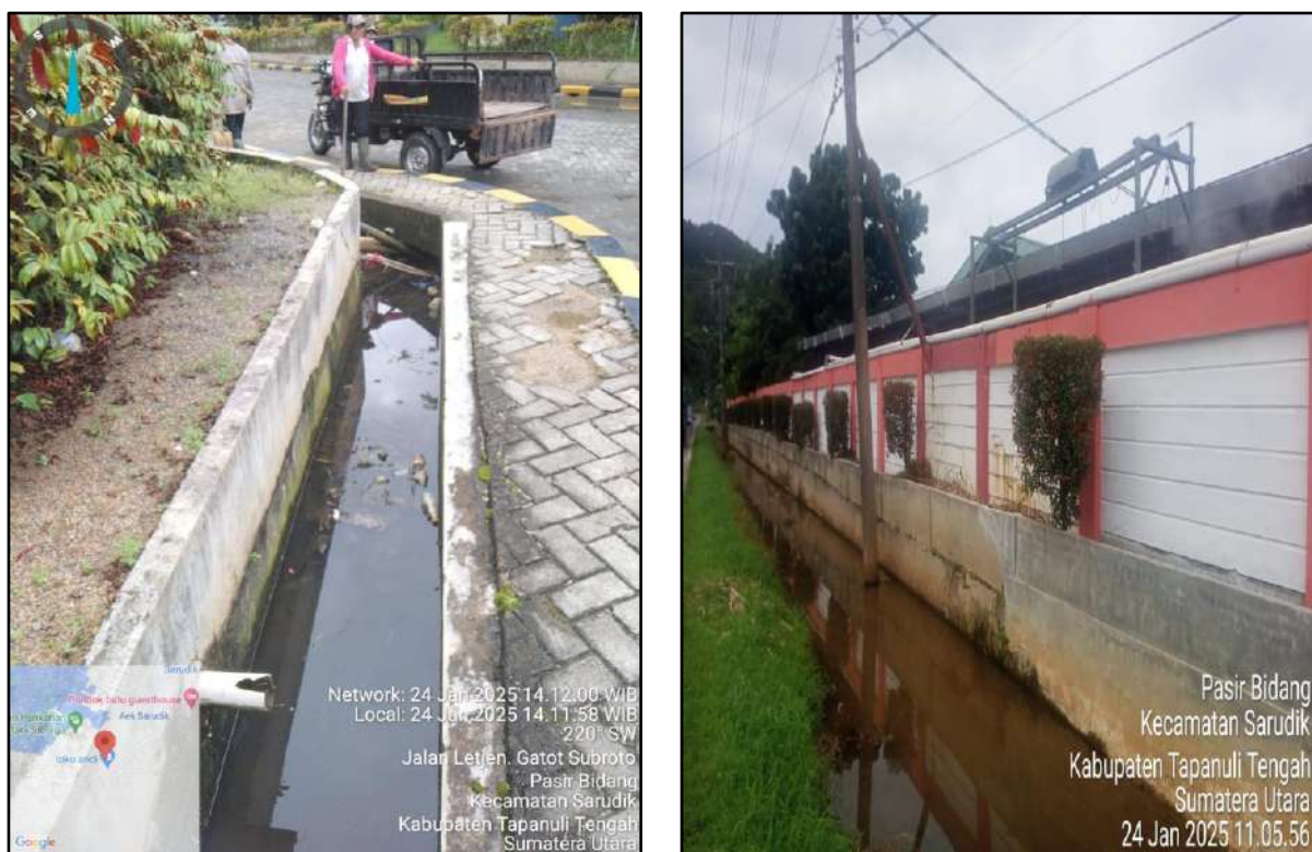
Gambar 1. Hasil identifikasi dan Jenis kerusakan drainase depan PPN Sibolga ( zona 1 dan zona 2)
